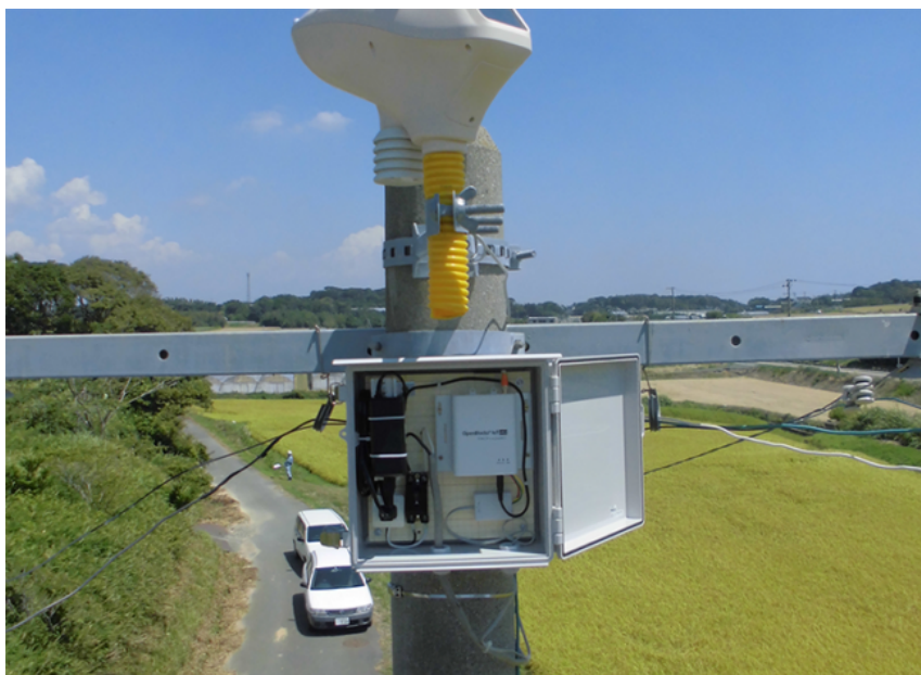
作業が容易でない高所の電柱に設置されたOpenBlocks。
